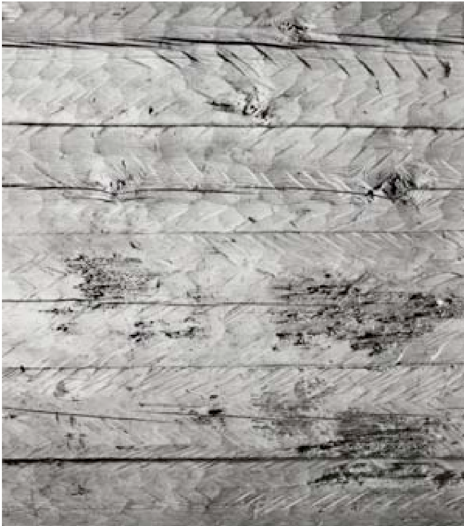
Bild 24. Foto från ATA:s arkiv med större parti av sprattäljd vägg från Södra Råda kyrka.
